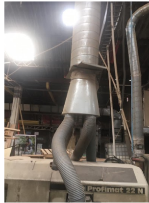
FOTOGRAFÍA N° 4. EQUIPOS DE CORTE
